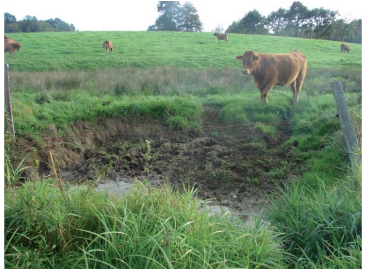
Encoche d'érosion due au piétinement des bovins sur le Grandrieux - © CCCSO
